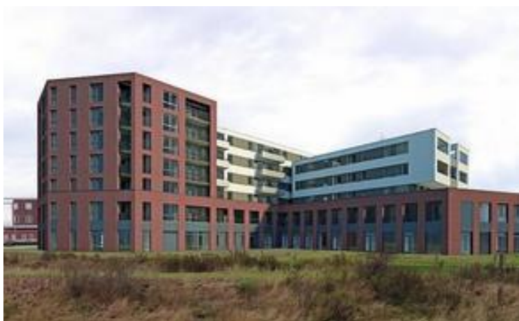
Het thans in aanbouw zijnde Ringovenpark gebouw H, I, en J te Panningen
